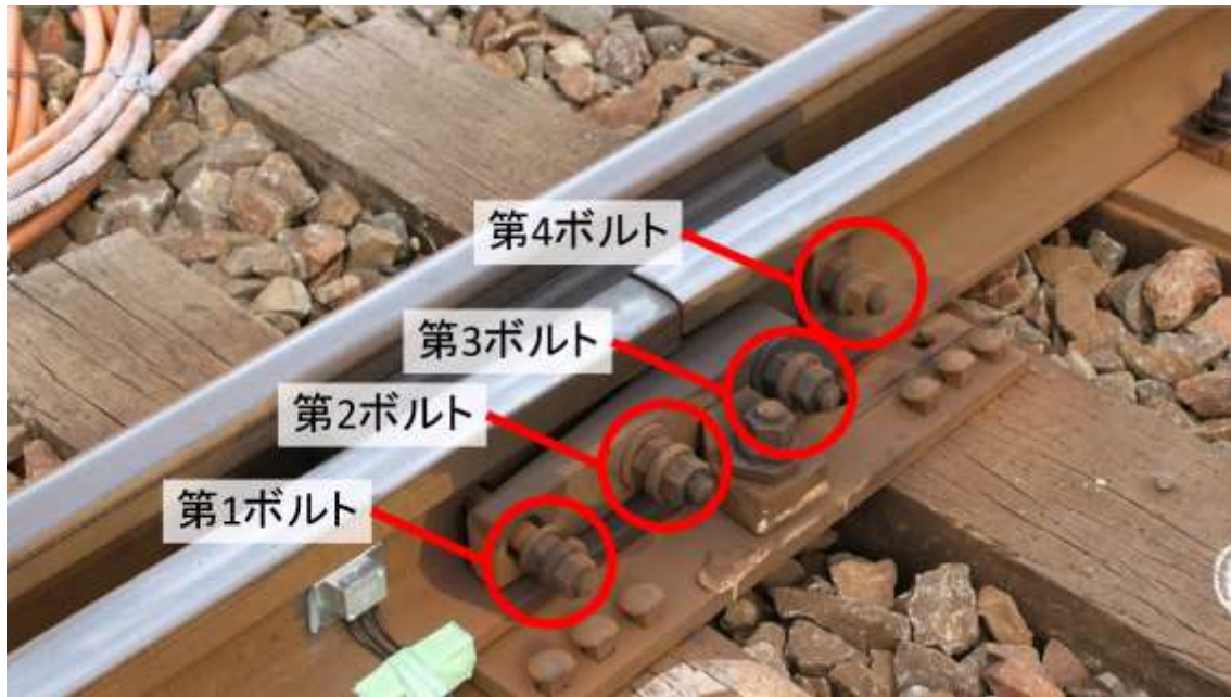
図 2.10 分岐器のトングレーール後端継目
