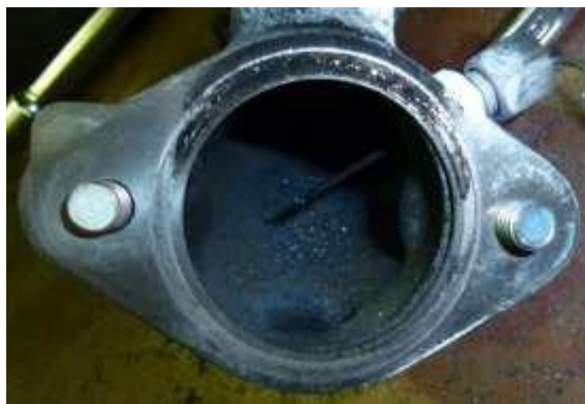
図 1-1 ガスケット部位からの漏洩
